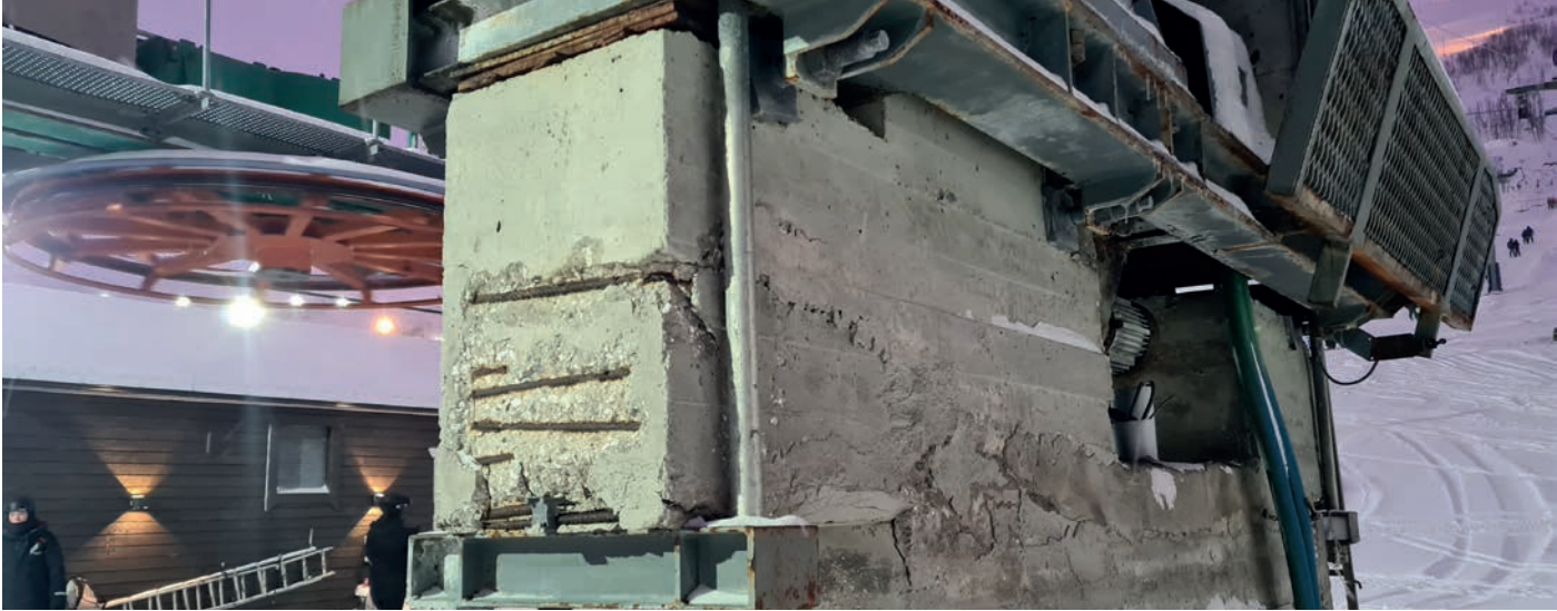
Figur 4. Korrosjon skjer når metaller utsettes for vann og oksygen, og er oftest et problem utendørs. Her ved en lokal skiheis i nærheten av en barneskole, der stålarmingen rustet. Foto: Jan Höper
